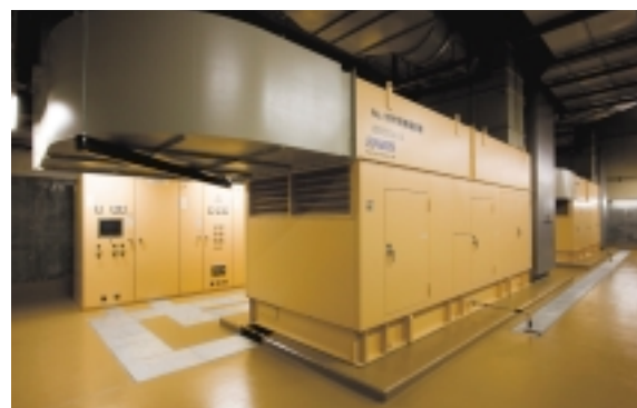
●非常用発電機
