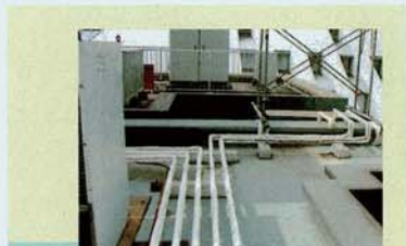
屋上冷媒配管
