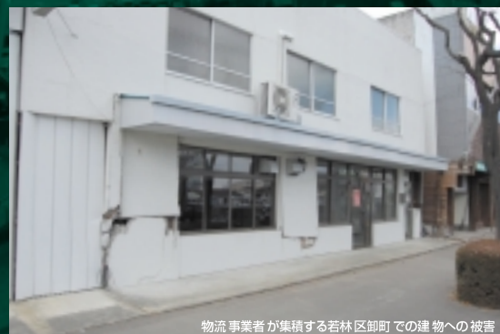
物流事業者が集積する若林区即町での建物への被害
