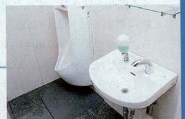
小便器下の床面には、防汚・防臭効果の高い汚垂石(ハイドロテクトステップ)を設置。
